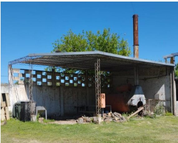
3. Galpón semicubierto que resguarda una caldera rota
