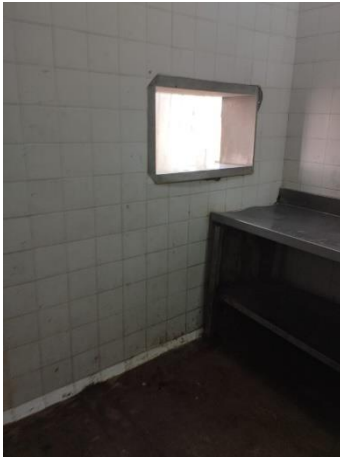
Sala de limpieza de cabezas
